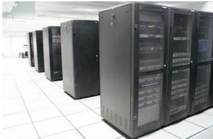
Fig. 1. Vista del CDI con el sistemas de bastidores con equipos tipo rack. Se puede observar que es una sola sala. (Fuente: Centro de Informática UCR 2012)
