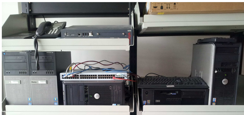
Fotografía 2. Servidores del COR-UIS
