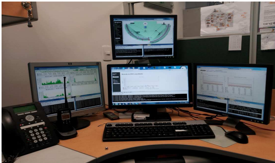
Fotografía 1. Centro de Operaciones de Red – Universidad Industrial de Santander
