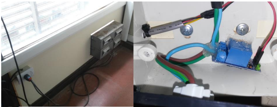
Fig. 5. Sistema de ventilación automático del Data Center. Observa la conexión del impulsor de aire (izquierda) con el actuador relé instalado dentro de la caja del tomacorriente (derecha).
